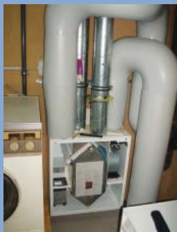
Obr. 11 Ukázka čistého provedení pomocí pevných rozvodů, které si vyžaduje i návrh trasování (vlevo). Chladné potrubí je izolováno parotěsnou izolací aby nedocházelo na jeho povrchu ke kondenzaci vlhkosti.
