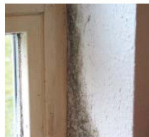
Obr. 12 Při nedostatečném utěsnění připojovací spáry okna dochází ke zvýšenému tepelnému a vlhkostnímu toku. Ve spojení s nedostatečným větráním je potom výsledkem plesnivění ostění, parapetů a rámu oken. Tím dochází k mnohem rychlejší degradaci materiálů.
