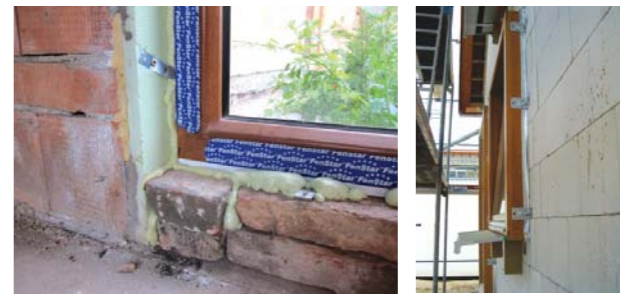
Obr. 7 Špatný příklad okna (vlevo) s porušením všech principů správného osazení. Okno je podloženo plnými cihlami procházejícími ven, bez použití těsnících materiálů a s nekorektním použitím kotvicích prostředků. Naproti tomu pěkný příklad předřazené montáže okna (vpravo) do roviny tepelné izolace s použitím těsného napojení na konstrukci. Rám okna je následně překrytý min. 4 cm venkovní izolace.
