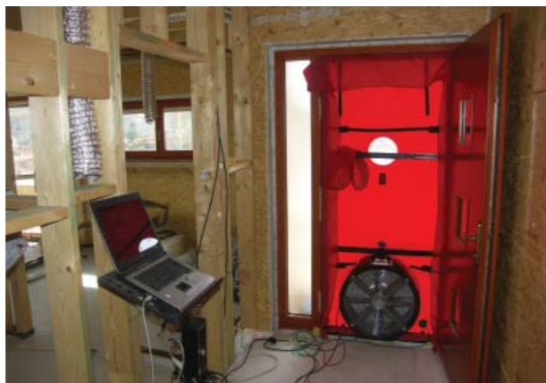
Obr. 11 Měření neprůvzdušnosti je nezbytnou součástí realizace a zajištění kvality pasivních domů. Po dokončení vzduchotěsnicí vrstvy je nutné provést měření, aby odhalené netěsnosti mohly být včas opraveny. (Zdroj Stanislav Paleček)
