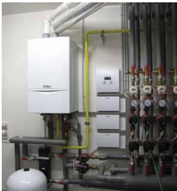
Obr. 21 Téměř prázdná technická místnost s kondenzačním plynovým kotlem pro šest bytů na teplo a teplou vodu.
