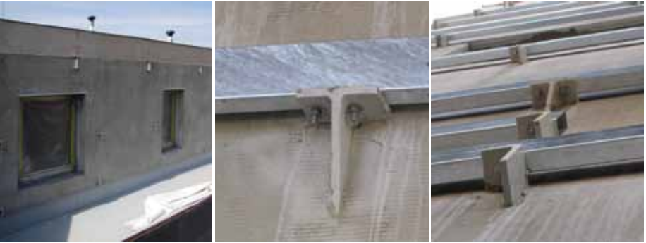
Obr. 11, 12,13 Povrch fasády s obkladem cementovláknitými deskami je zavěšen na kotvy z laminátových profilů a podložkami Compacfoam s omezením tepelné vazby
