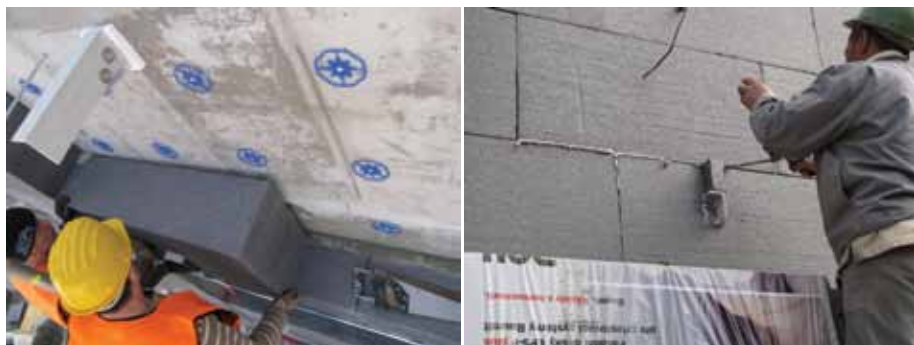
Obr. 9, 10 Velké úsilí bylo třeba na vysvětlení a kontrolu vyplnění všech dutin a větších spár v EPS
