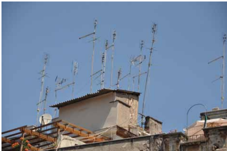
Obr. 1 Instalace „společné antény“, foto: autor
