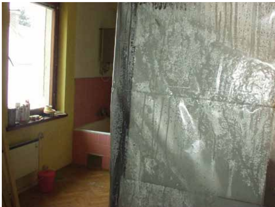
Obr. 2 Parozábrana ještě bez izolační vrstvy v podkroví, během několika hodin plná kondenzátu, ukazuje průchod vlhkosti skrze starou, omítnutou tenkou stěnu. Po izolování slámou na studené straně suchá.
