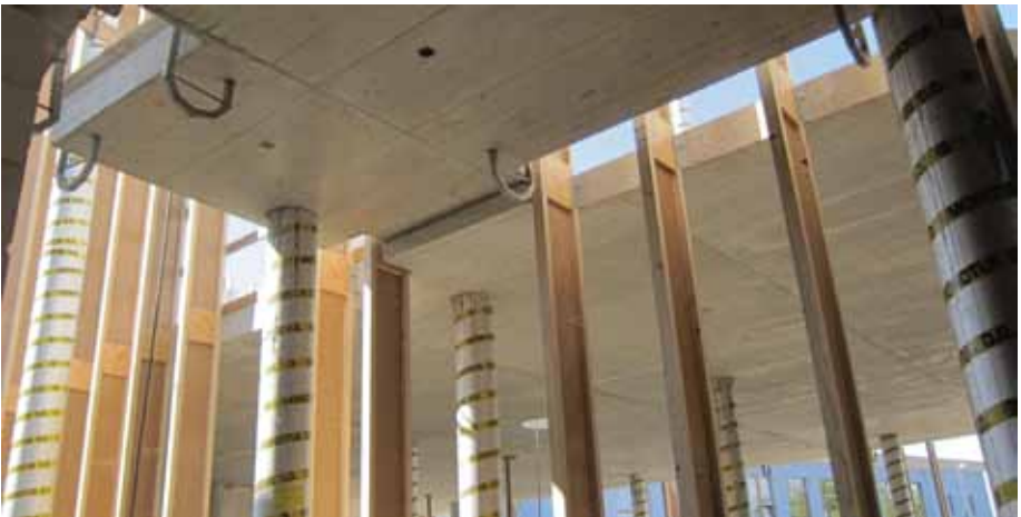
Obr. 10 Stropní desky vytápěné MŠ a nevytápěné přístupové chodby – pro eliminaci tepelných mostů jsou stropní desky samostatné, tepelněizolační plášť probíhá a pouze v místě dveří a ze statických důvodů jsou desky bodově propojeny.
