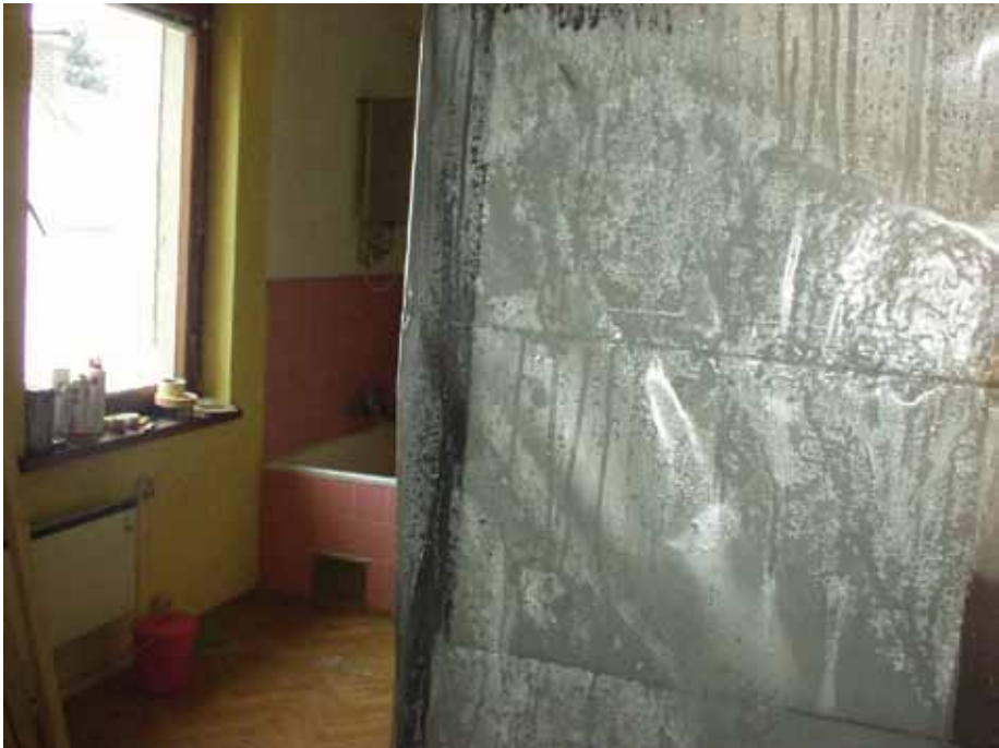
Abb. 2 Dampfbremse noch ohne Dämmlage im Dachraum, innerhalb weniger Stunden voll mit Kondensat, zeigt den Feuchtedurchgang durch die alte, verputzte Leichwand auf. Nach Dämmung mit Stroh auf der Kaltseite trocken.
