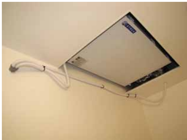
Obr. 17 V komoře umístěna lokální rekuperační jednotka s odvodem kondenzátu
