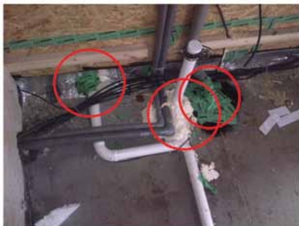
Obr. 5 Nesprávně provedený detail prostupu PVC trubky konstrukcí
