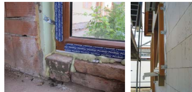
Obr. 7 Špatný příklad okna (vlevo) s porušením všech principů správného osazení. Okno je podloženo plnými cihlami procházejícími ven, bez použití těsnících materiálů a s nekorektním použitím kotvicích prostředků. Naproti tomu pěkný příklad předsazené montáže okna (vpravo) do roviny tepelné izolace s použitím těsného napojení na konstrukci. Rám okna je následně překrytý min. 4 cm venkovní izolace.
