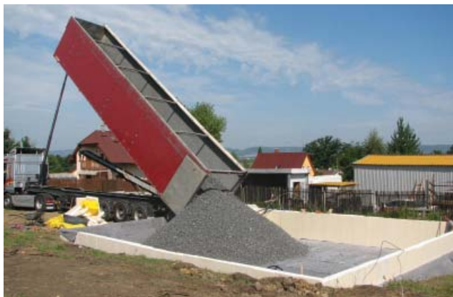
Obr. 12 Štěrk z pěnového skla je často používán při zakládání betonové desky na izolaci. Na ztuhlé vrstvě pěnoskla se následně provede armovaná železobetonová deska. (Foto: Kalksandstein)
