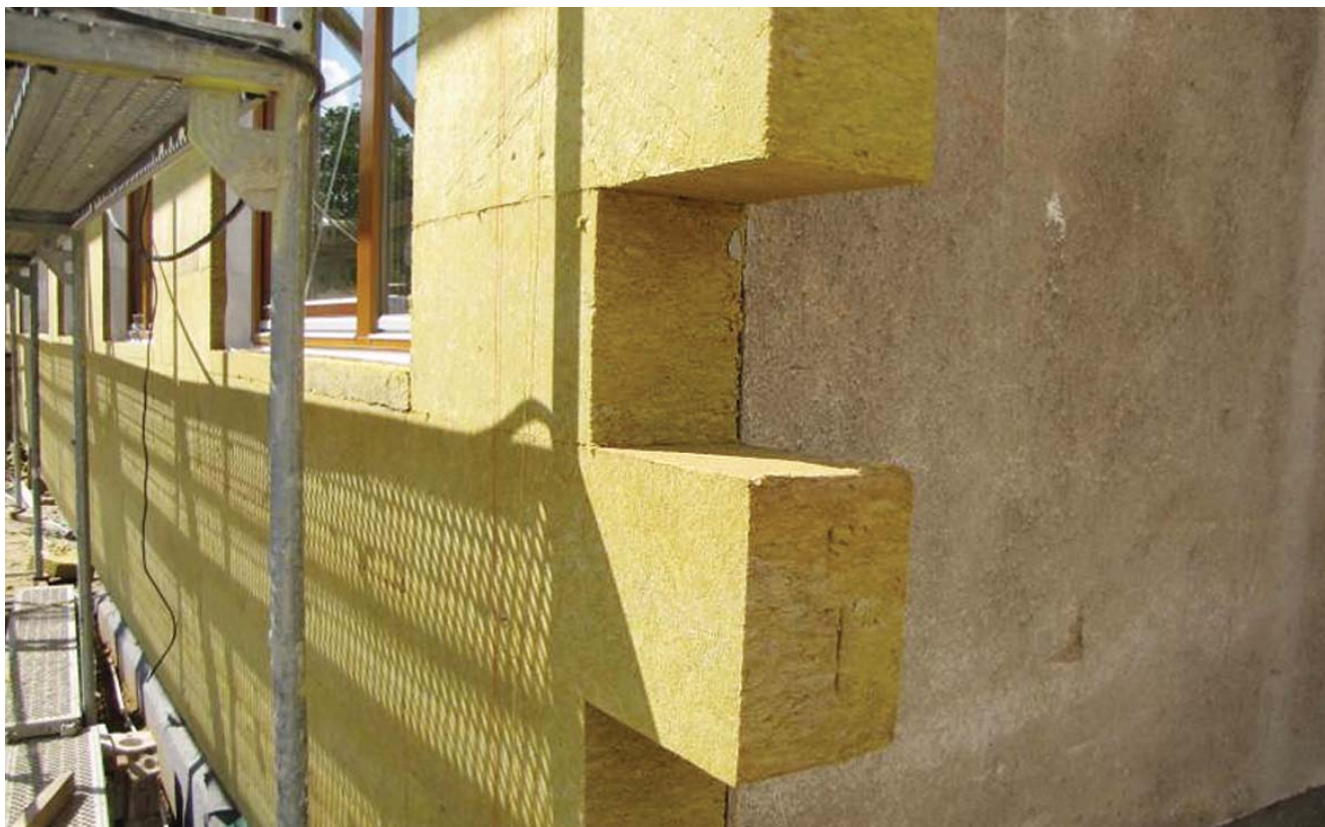
Obr. 1 Zcela zbytečná je také debata nad návratností investice do silnější vrstvy izolace. Náklady na navýšení tloušťky jsou totiž většinou podstatně menší než náklady spojené s její aplikací. Návratnost investice do silnějšího zateplení domu je maximálně v řádu několika let. Ceny energie však zcela jistě porostou a úměrně tomu se bude i snižovat návratnost. Vnější zateplovací systém také podstatně prodlužuje životnost konstrukce. Mírně vyšší počáteční investice je tedy i z tohoto pohledu velmi výhodná. (Foto A. Brotánek)
