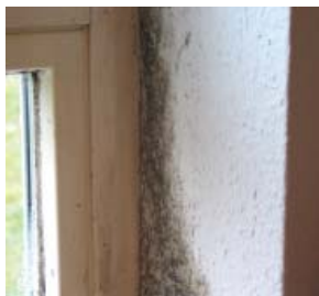
Obr. 12 Při nedostatečném utěsnění přípojovací spáry okna dochází ke zvýšenému tepelnému a vlhkostnímu toku. Ve spojení s nedostatečným větráním je potom výsledkem plesnivění ostění, parapetů a rámu oken. Tím dochází k mnohem rychlejší degradaci materiálů.
