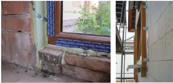
Obr. 7 Špatný příklad okna (vlevo) s porušením všech principů správného osazení. Okno je podloženo plnými cihlami procházejícími ven, bez použití těsnících materiálů a s nekorektním použitím kotvicích prostředků. Naproti tomu pěkný příklad předsazené montáže okna (vpravo) do roviny tepelné izolace s použitím těsného napojení na konstrukci. Rám okna je následně překrytý min. 4 cm venkovní izolace.
