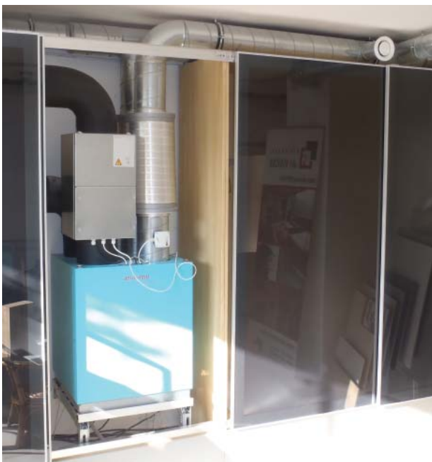
Obr. 12 Větrací jednotku lze umístit pod strop v komunikačním prostoru, do koupelny nebo třeba i do skříně vstupní haly. Rozvody jsou pak řešeny pod stropem v podhledu nebo i příznané v interiéru. (Zdroj TAUSCH)
